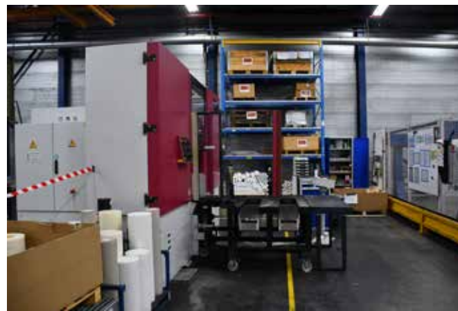
De installatie van de HBE 560A Performance van Behringer gebeurde eind oktober. Sindsdien gebeurt het zaagwerk een stuk veiliger, maar ook een stuk stabiel.
